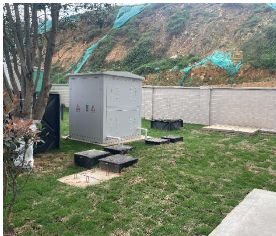
那拔收费站污水处理设施
