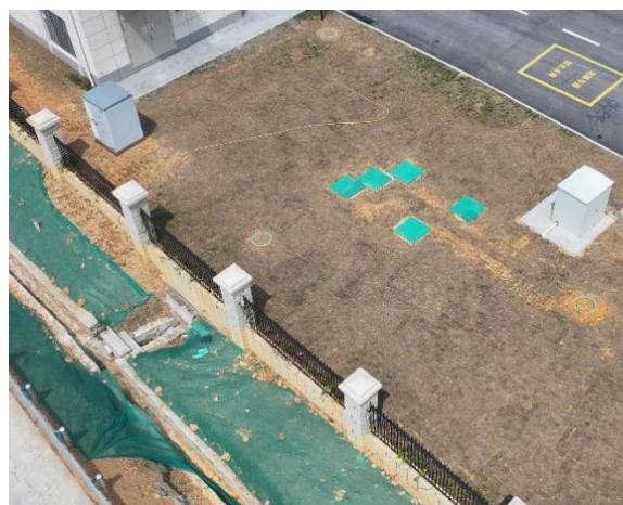
玉凤服务区右侧污水处理设施
