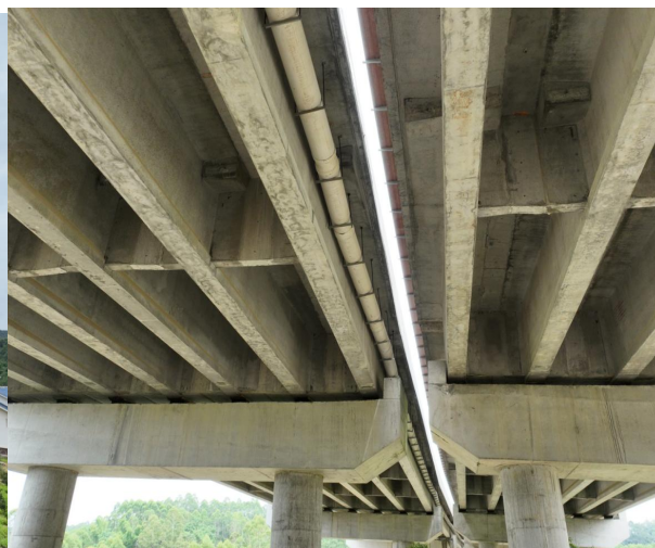
韦就大桥右幅桥面径流收集管
