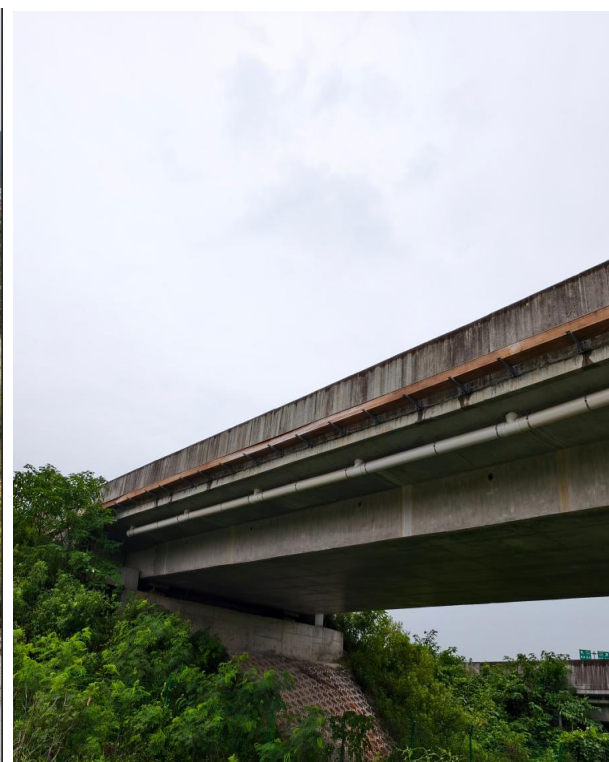
C 匝道 1 号中桥桥面径流收集管
