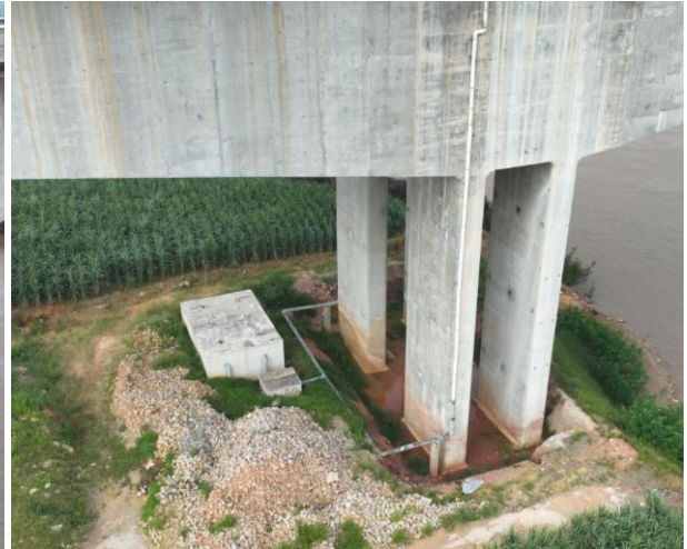
排入沉淀池收集管
