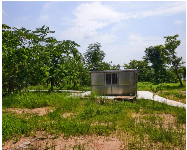
宾阳南服务区污水处理设施
