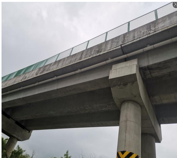
G 匝道桥桥面径流收集管
