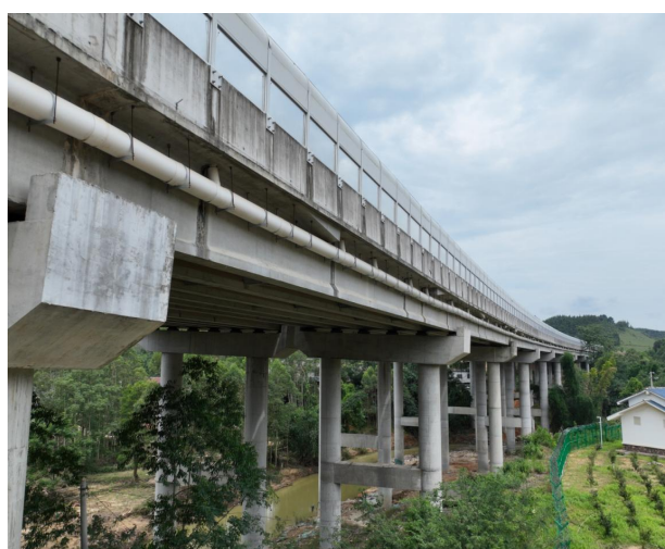
韦就大桥左幅桥面径流收集管
