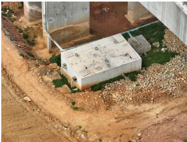
K2+890 沉淀-事故应急池（南岸）
