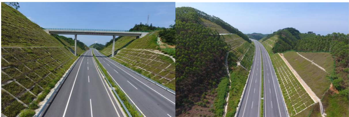
典型挖方路段植物防护现状
