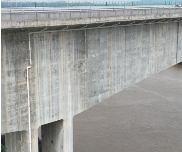
桥面径流收集管
