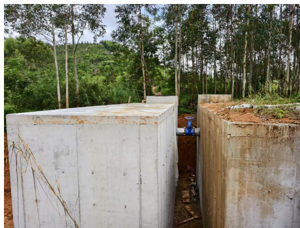
K24+250 左侧沉淀-事故应急池
