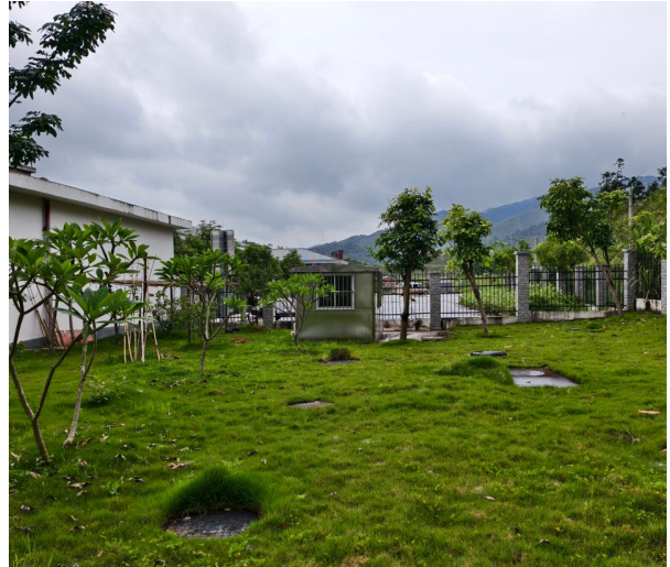
陈平服务区（下行）污水处理设施
