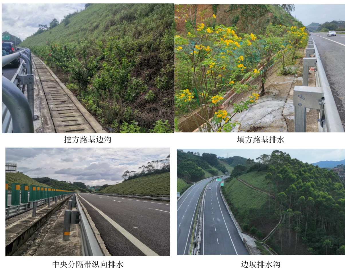
图 5.3-7 典型公路排水设施现状
