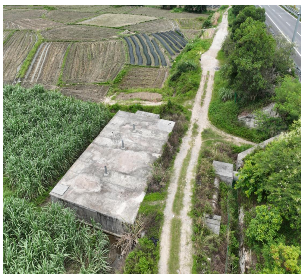
K42+986 左侧沉淀-事故应急池
