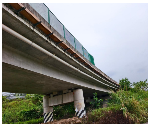
F 匝道桥桥面径流收集管
