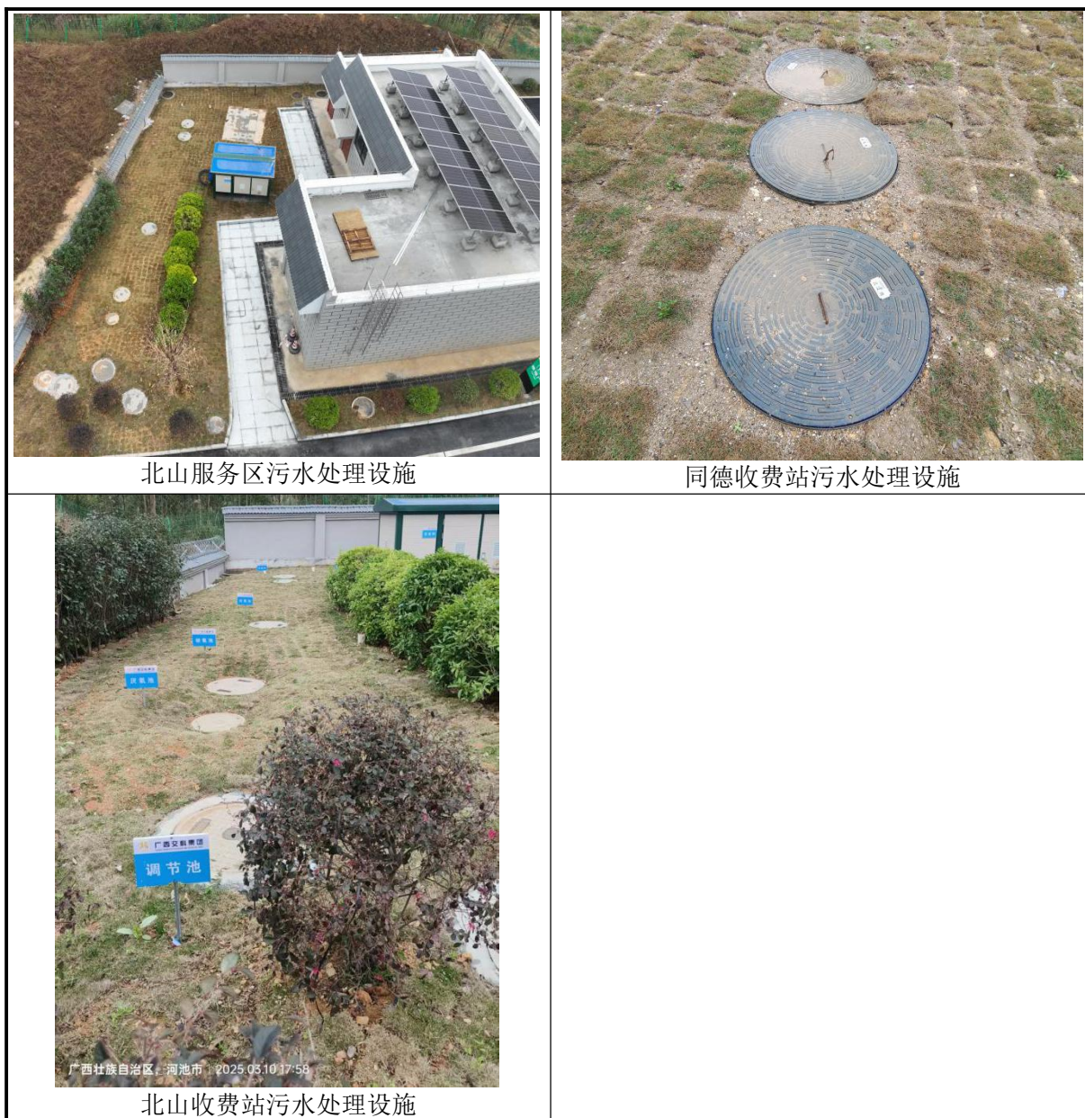
图 8.2-1 本项目沿线设施污水处理设施现状
