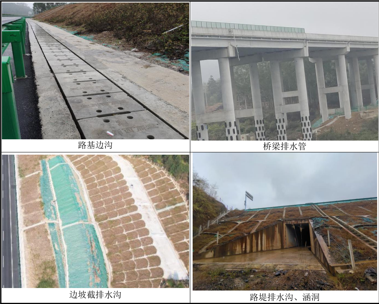
图 5.3-5 典型公路排水设施现状
