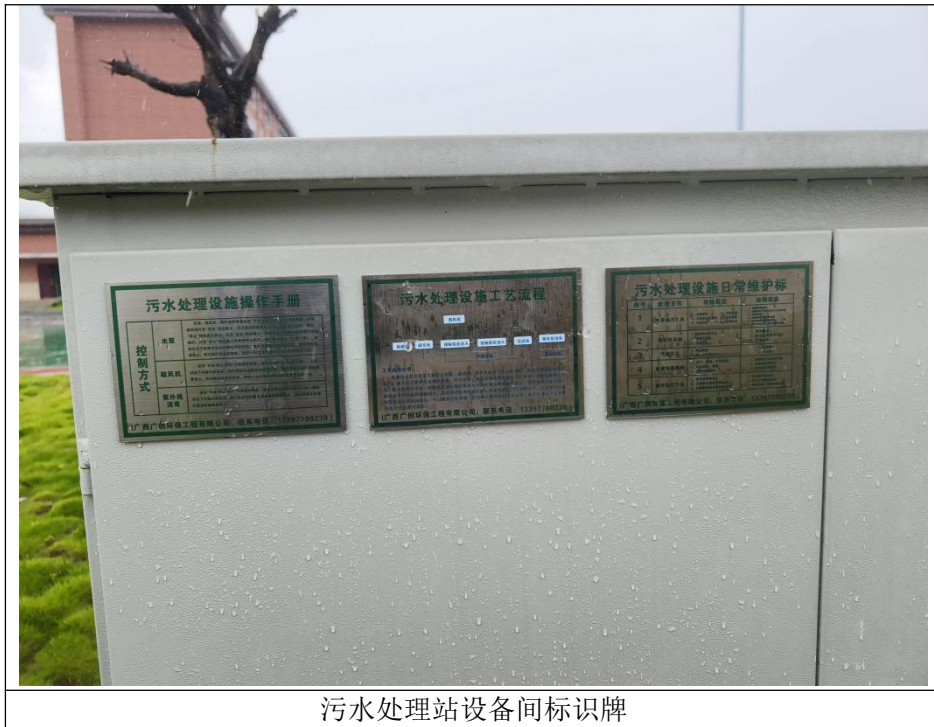
图 8.2-3 沿线服务设施污水设备现场情况图
