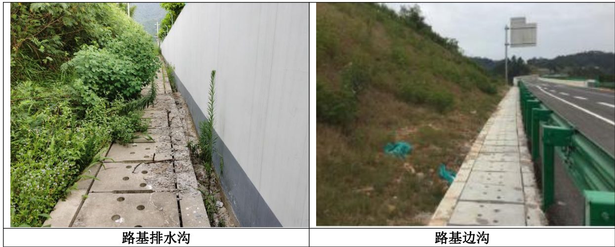
图 6.3-4 本项目典型排水设施现场图片
