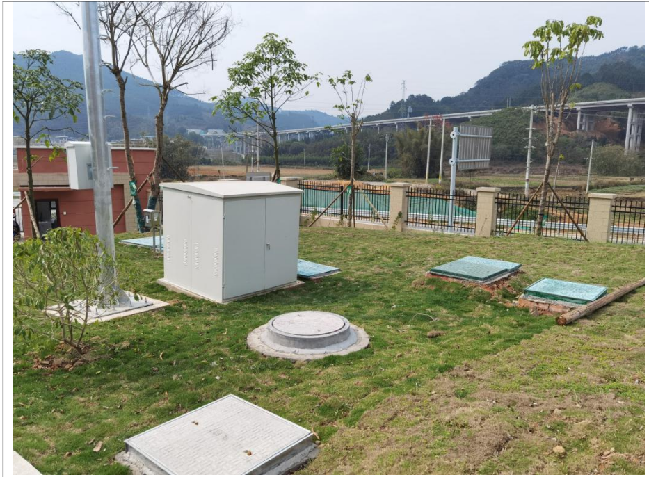
朔良收费站污水处理站设备间
