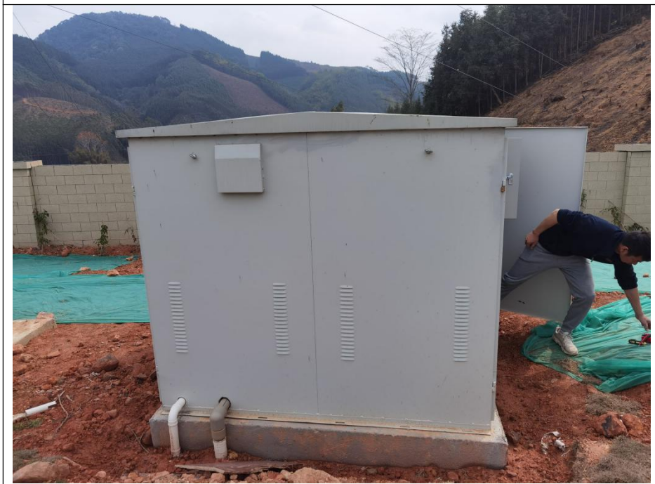
义圩服务区污水处理站设备间
