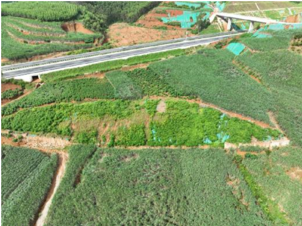
边坡分级植草灌，坡脚挡渣墙，主线截排水沟，复耕，汇水由主线排水沟排放
