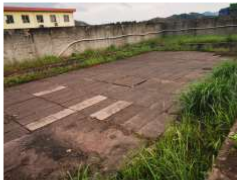
初期雨水沉淀池（地埋式）
