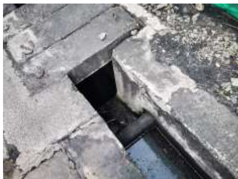
溢流式排水沟
